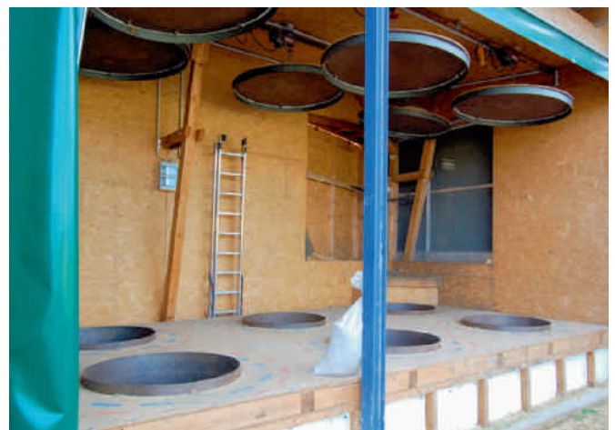
Abb. 9: Zweireihige Anlage mit Bodenkanal aus Holzwerkstoff. Oben sind die Ballendeckel sichtbar, unten eine Wärmedämmung des Bodenkanals.
