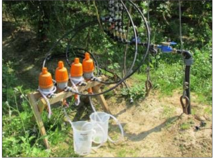
Abb. 1.2: Düngereinspeisevorrichtung zur Fertigation
