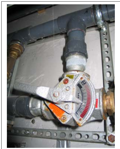
Abb. 8: Handregelung zur Steuerung der Vorlauftemperatur des Kühlwassers durch Einmischen von Rücklaufwasser in den Vorlauf
