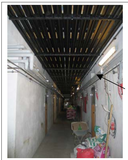
Abb. 5: Kühldecke und unterhalb liegende Zuluftöffnungen (Pfeil) in die Stallabteile
