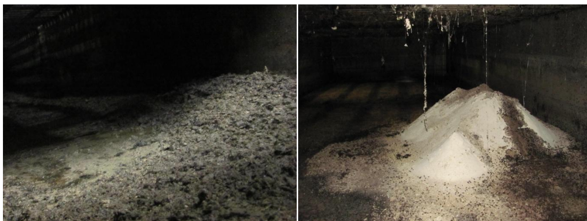
Abbildung 12: Matsch und Futterreste in den Kanälen unterhalb der Abrufstationen
