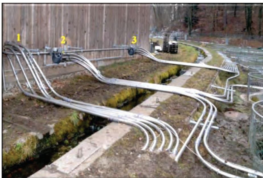
Abb. 6: Rotationsverteiler (Nrn. 2 und 3) und Futterrohrleitungen (Nr. 1) zu den Versuchsteichen.
