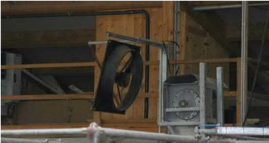
Abb. 38: Eingebauter Ventilator mit Selbstbaulösung der Aufhängung am Betrieb 2
