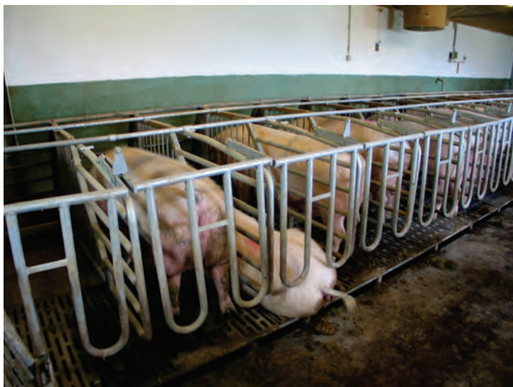
Abb. 24: Diese Stufen müssen beseitigt werden
