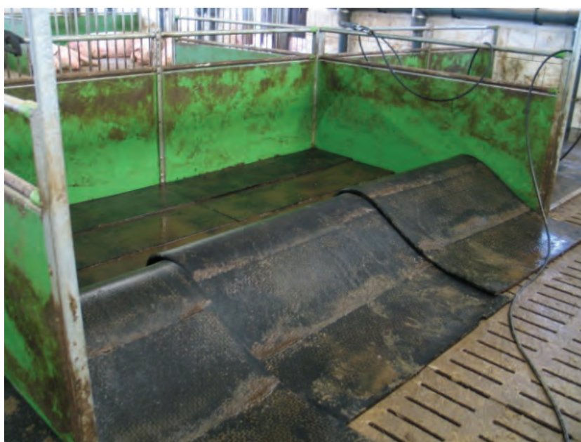
Abb. 9: Zur Buchtenreinigung wurden die Matten weggeklappt
