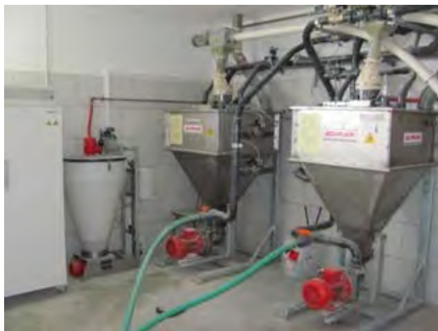
Abb. 21: Flüssigfütterungsanlage mit Kleinmengendosierer (links) zur Inulingabe
