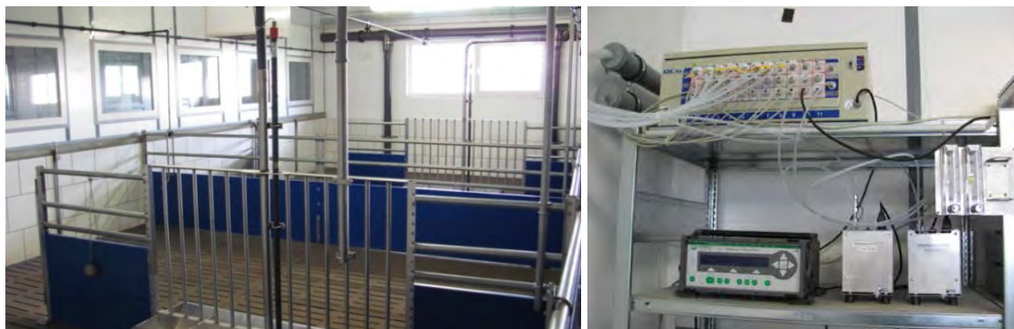
Abb. 19: Mastabteil mit Schadgasmessung und photoakustische Messanlage
