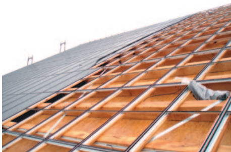
Abb. 13: Dachabsaugung kombiniert mit Fotovoltaik.
