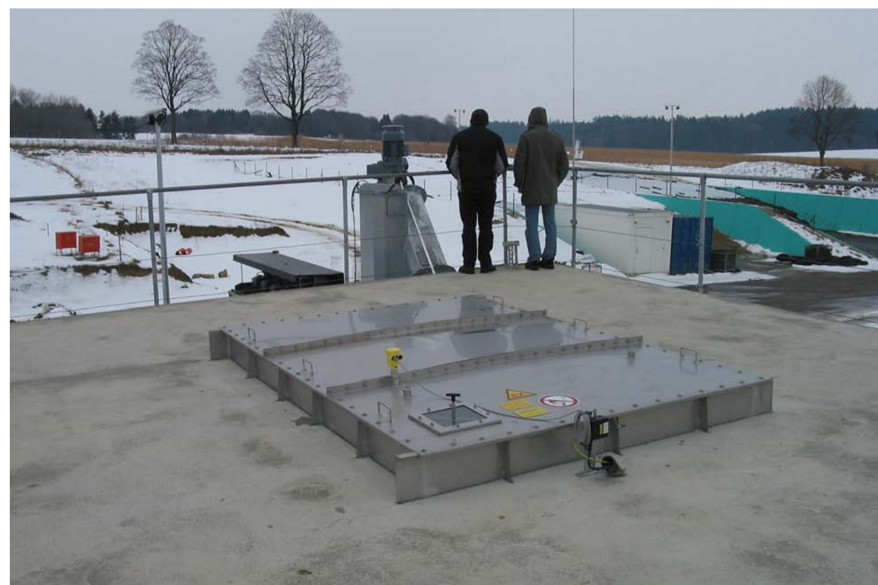
Servicehaube im vorderen Teil des Hauptfermenters
