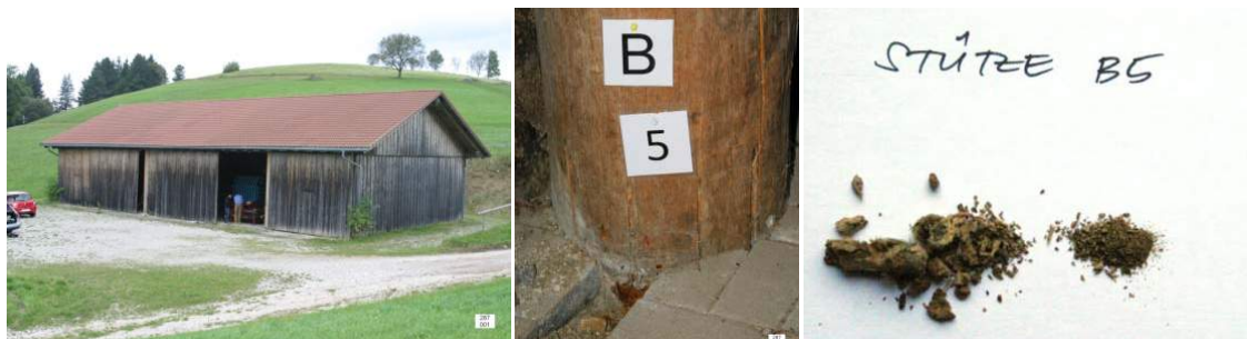
Untersuchte Maschinenhalle, Detail Stützenfuß und schadhafter Bohrkern
