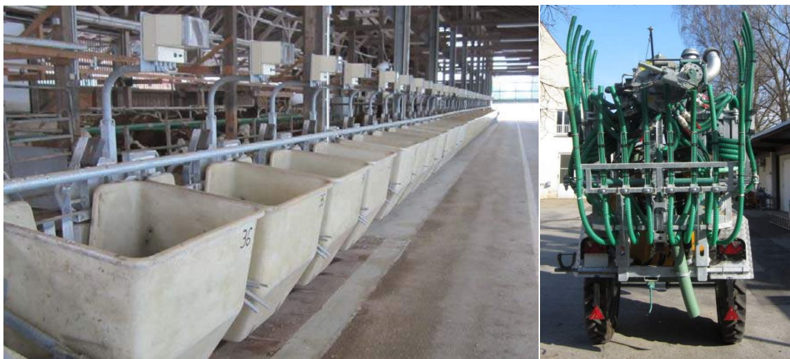
links: Erweiterung Grundfutterwiegetröge im AMS-Stall Grub, rechts: Umbau am Gülletankwagen für Versuchsanlagen
