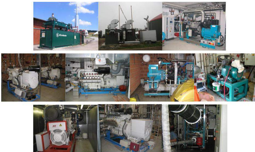
Biogas-BHKWs unterschiedlicher Leistungsklassen (30 - 526 kW el. ) in der Praxis
