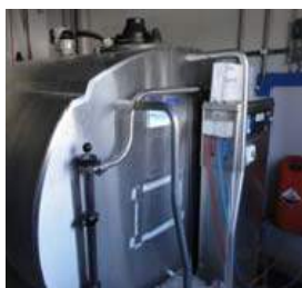
Milchtank und Reinigung
