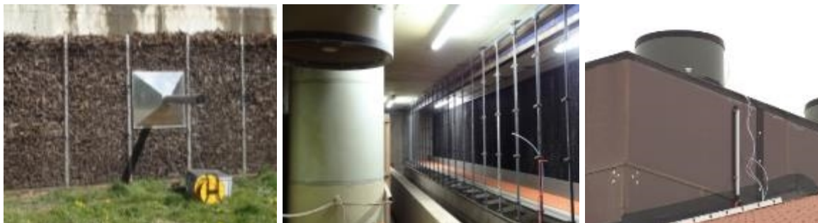
Probennahme Reingas mit Haube (links), Messpunkt Rohgas (Mitte), Messpunkt Reingas (Abluftkamin) (rechts)
