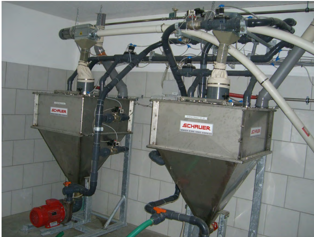
Flüssigfütterungsanlage mit 2 separaten Anmischbehältern und Kreisläufen
