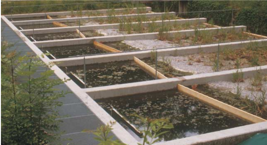
Bodensystempflanzenkläranlage mit vorgelagertem Absetzbereich
