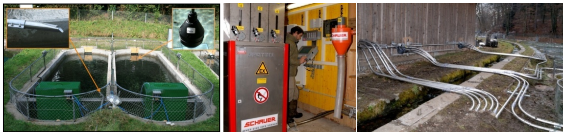
Moderne Technik in der Forellenproduktion: Stromlose Sauerstoffeintragsgeräte mit Sauerstoffsteuerung (links), Fütterungszentrale (Mitte) und Futterrohre (rechts)
