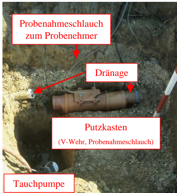
Abb. 9: Abflussmessung und Probenahme am Drän
