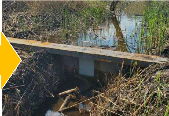
Graben mit Stauwehr inklusive Schieber
