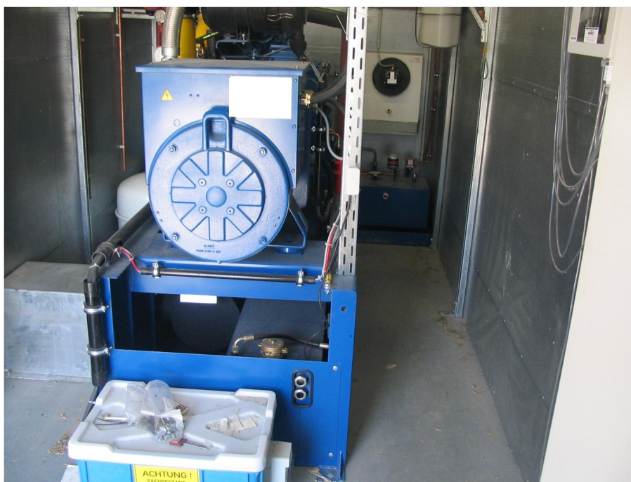
Abb. 10: 110 kW el , Zündstrahl-BHKW in der Praxis
