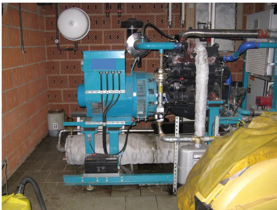
Abb. 8: 40 kW el . Zündstrahl-BHKW in der Praxis
