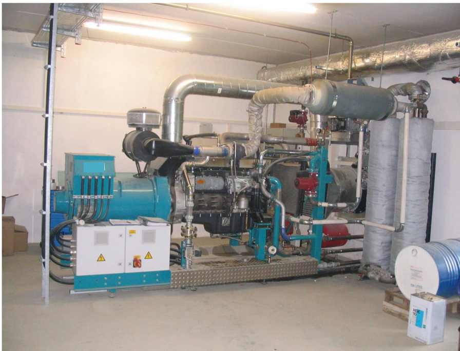
Abb. 11: 250 kW el. Zündstrahl-BHKW in der Praxis
