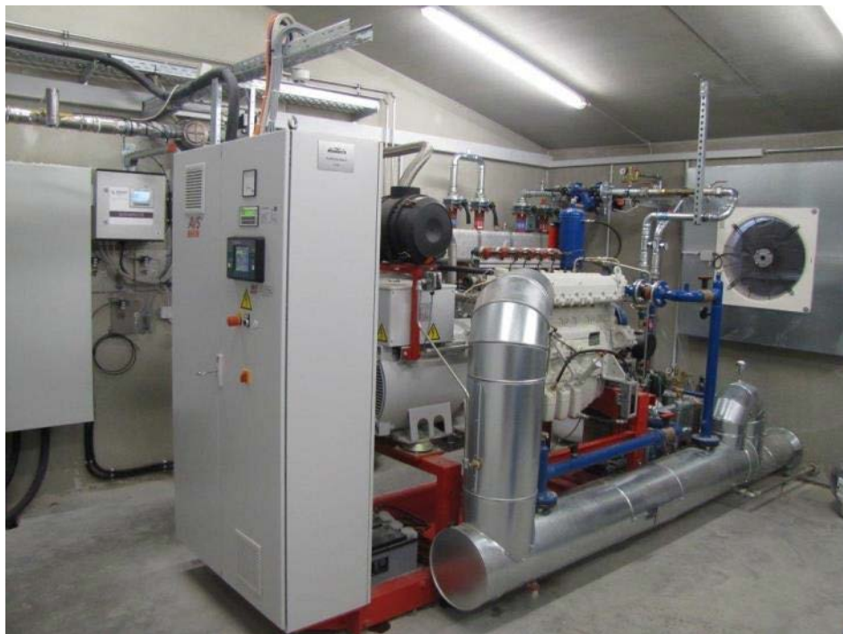
Abbildung 9: Das Grundlast-BHKW ausgestattet mit einem Gas-Otto-Motor mit 75 kW elektrisch installierter Leistung
