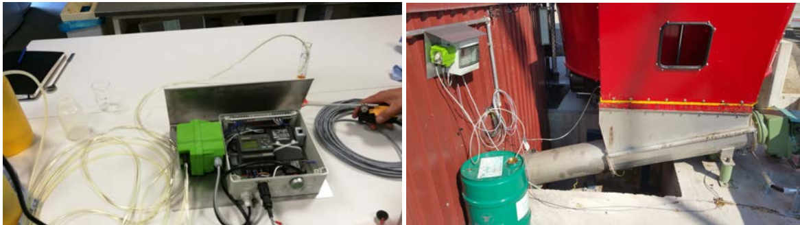
Abbildung 24: Aufbau und Einsatz einer automatisierten Rapsölpumpe zur kontrollierten Bekämpfung der Schaumbildung
