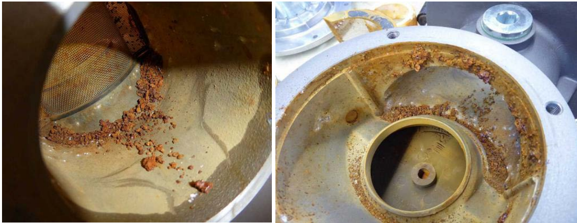
Abbildung 41: Ablagerungen/Verschmutzung am Magnetventil vor der Gasfackel
