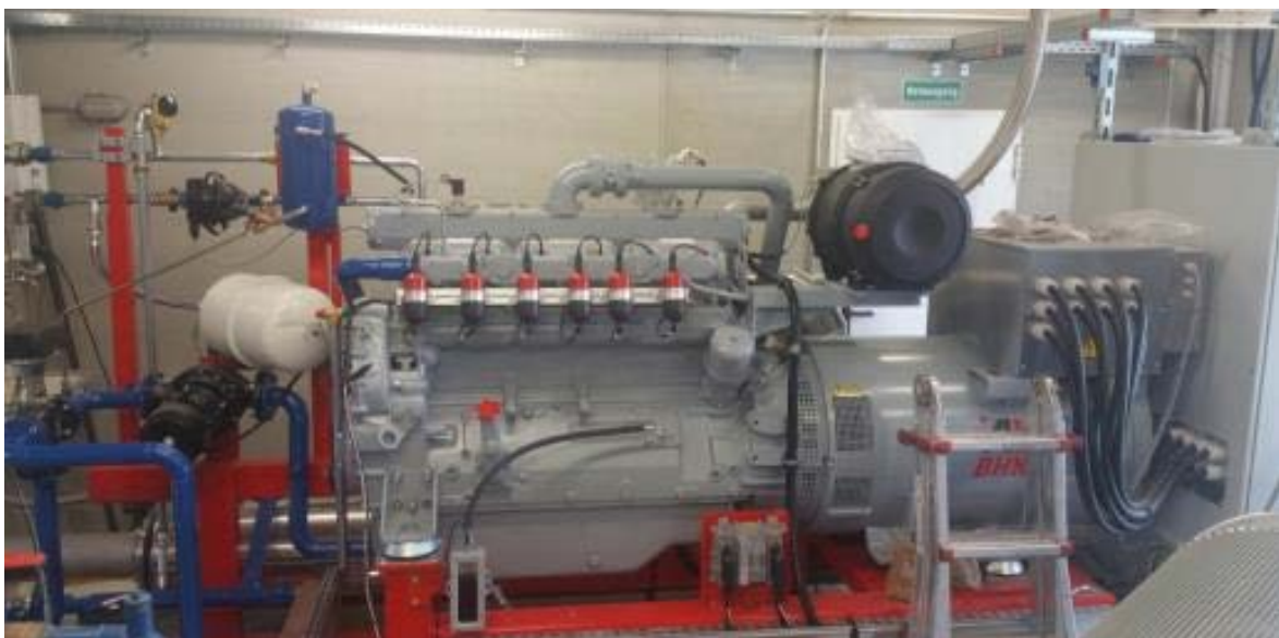
Abbildung 10: Spitzenlast-BHKW mit einer elektrischen Nennleistung von 203 kW
