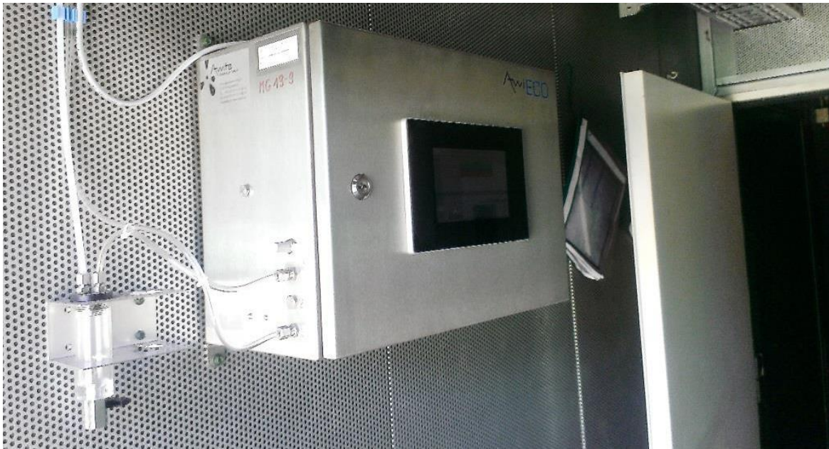
Abbildung 2: Gasanalysestation der Pilotbiogasanlage #24
