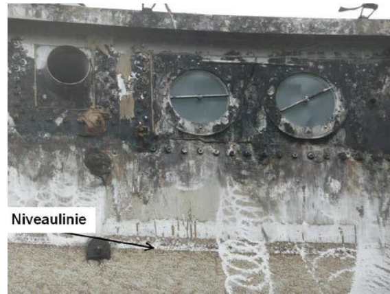
Abbildung 6: Fermenterwand im Gasraum nach Entfernung des Schwefelbelages.
