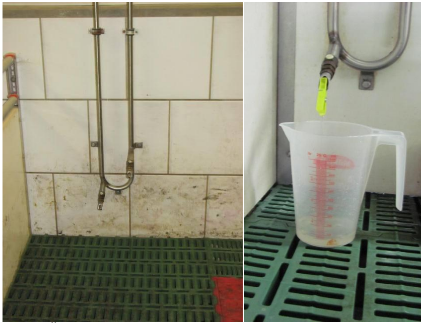
Abb. 3: Überprüfung des Wassernachlaufes im „Normalbetrieb“ - – „Öffnen“ der Nippel mit Wäscheklammern
