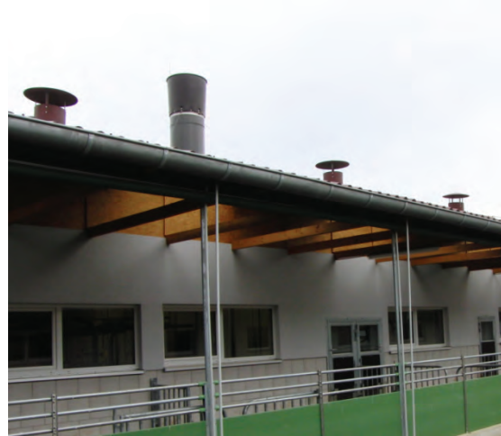
Abb. 12: Abluftkamine mit Abdeckhaube bzw. Diffusor
