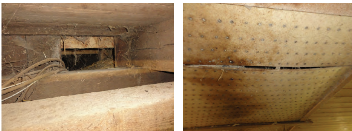
Abb. 13: Zu kleine, verschmutzte Zuluftkanäle und verstopfte Porenplatten erhöhen neben der Staubbelastung den Energieverbrauch der Lüftungsanlage.
