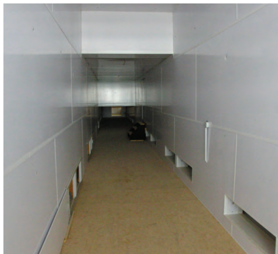
Abb. 3: Zuluftkanal im Dachraum
