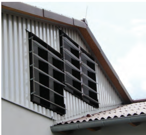
Abb. 2: Zuluftöffnung am Gebäude
